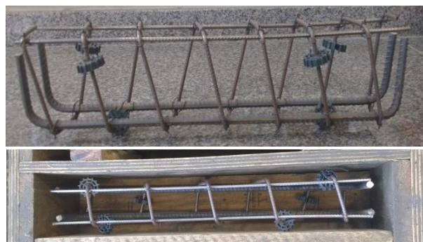
Figura 10 – Armadura V04 com estribos contínuos com Ø 5,0 mm e espaçamento de 7,5 cm (= a V03).
