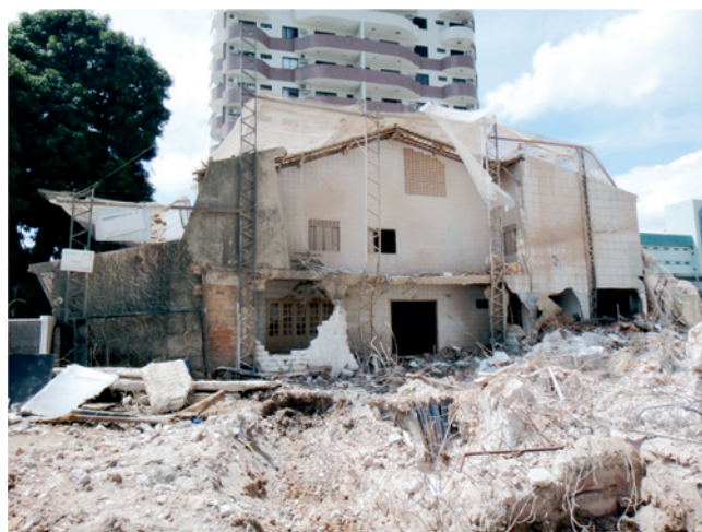
Figura 2 Edificação afetada pelos escombros do edifício Real Class
