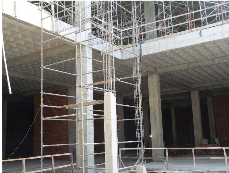
Figura 3: Incompatibilização entre a estrutura e arquitetura (SENA, 2014)
