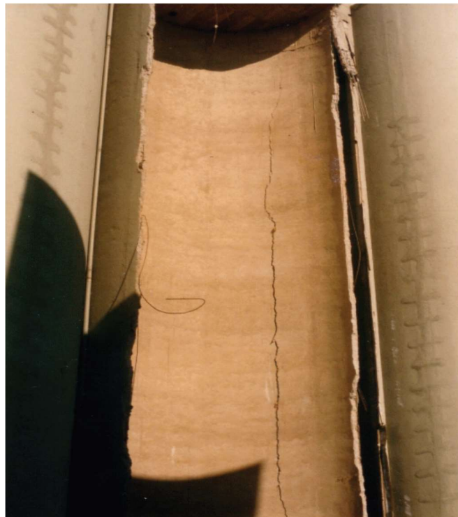
Figura 17: Fissura vertical em silos devido à tração tangencial (CARMONA, 2013)
