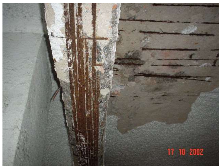
Figura 5: Taxa excessiva de armaduras (ZAPLA, 2002)
