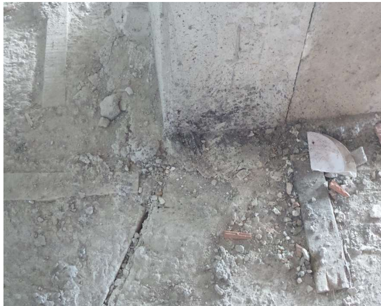
Figura 4: Junta de dilatação deslocada (SENA, 2014)
