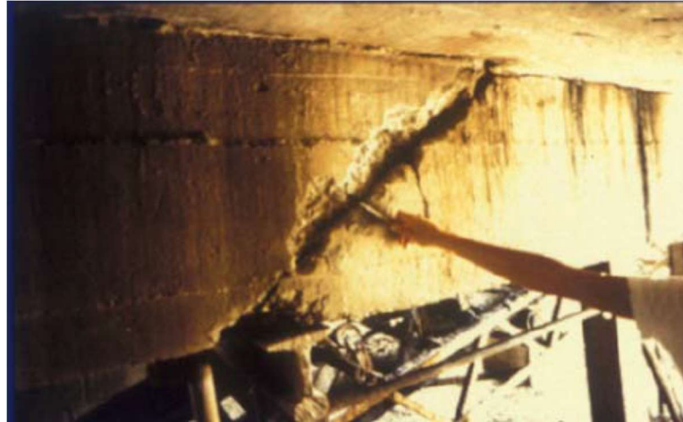
Figura 22: Fissura em viga causada por cisalhamento
