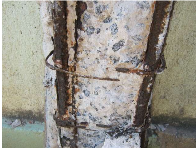
Figura 28: Corrosão de armadura
