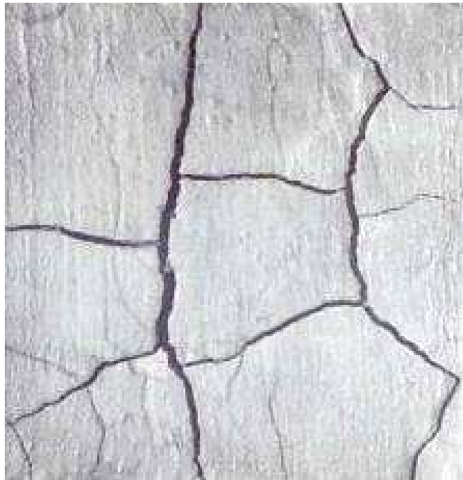
Figura 12: Retração no concreto endurecido
