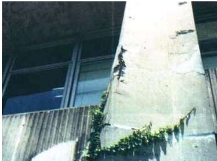
Figura 18: Pilar com destacamento do cobrimento e apresentando flambagem da armadura longitudinal
