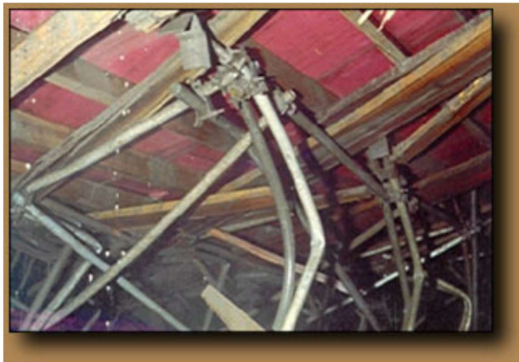
Figura 10: Escoramento mal executado (MARQUES, 2013)
