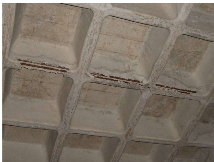
Figura 7: Lançamento e adensamento inadequados (SENA, 2014)
