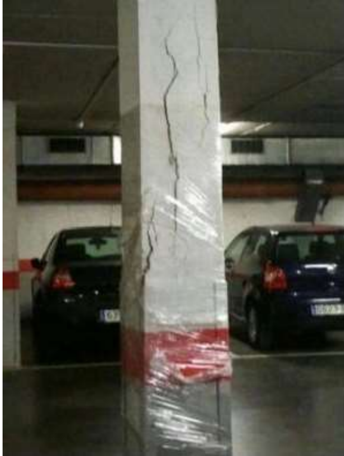
Figura 15: Fissuração em pilares devido à carga excepcional
