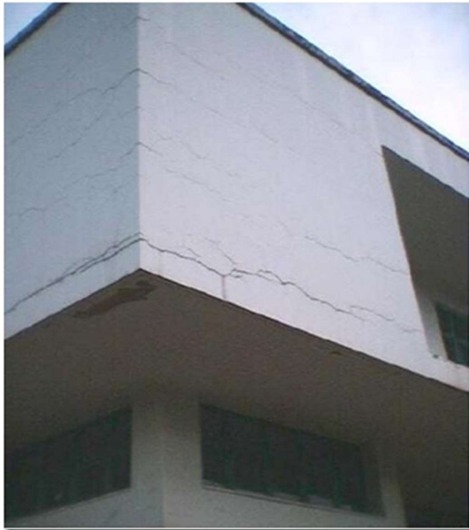
Figura 16: Fissuração devido à sobrecarga
