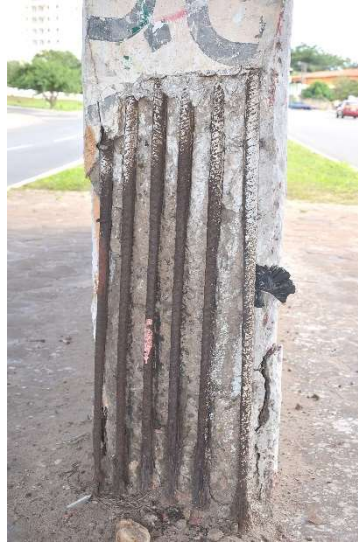
Figura 32: Armadura exposta por falta de manutenção no Viaduto do Café em São Luís/MA FONTE: Jornal Pequeno, 2013
