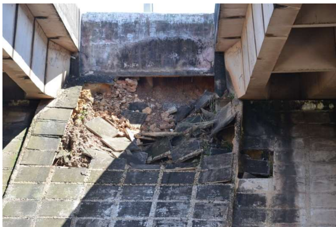
Figura 31: Falta de manutenção no Viaduto do Trabalhador em São Luís/MA FONTE: Jornal Pequeno, 2013
