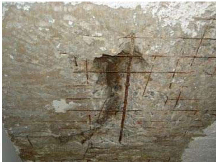
Figura 6: Dimensão máxima do agregado graúdo inadequada
