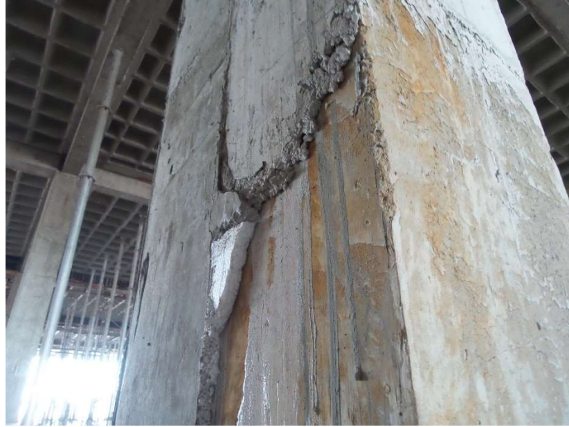
Figura 30: Falha na emenda de fôrma (SENA, 2014)
