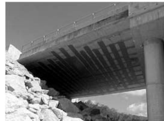
Fotografia 9.10 – Reforço de viaduto urbano em Belo Horizonte - MG. Reforço de ponte ferroviária sobre o Rio Quatis, em Aymorés - MG.
