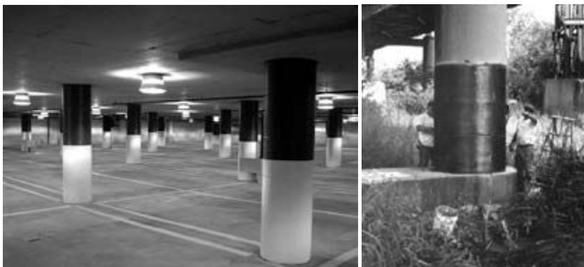
Fotografia 2.6 – Colunas reforçadas por confinamento para efeitos sísmico.
