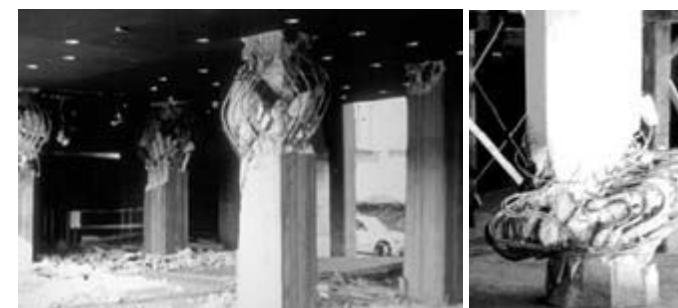
Fotografia 2.5 – Pilares fendilhados por efeitos sísmicos.
