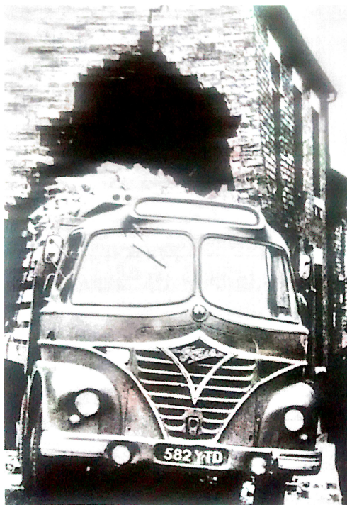
Figura 16 – Colisão de um caminhão em parede de alvenaria que se mantém estável devido ao efeito arco [3].
