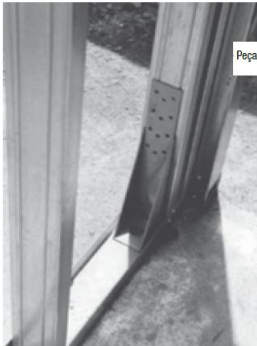
Figura 30: Ancoragem com parabolt.
