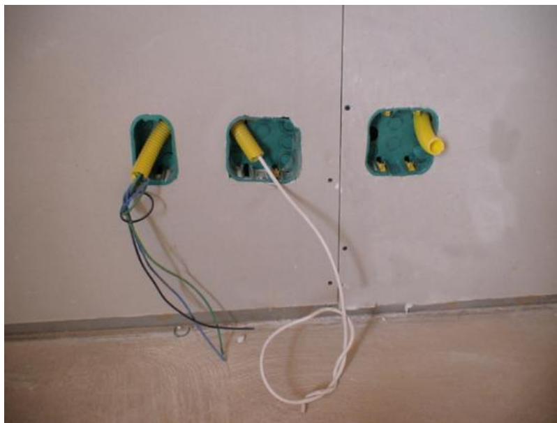
Figura 65: Instalação elétrica no LSF.
