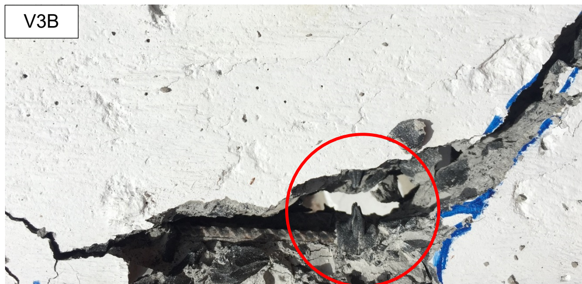
Figura 37: Detalhe da ruptura dos estribos de plástico Fonte: Aatoria própria, 2018.
