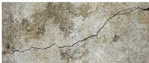
Figura 3 – Fissuração em concreto armado. Fonte: AECWeb
