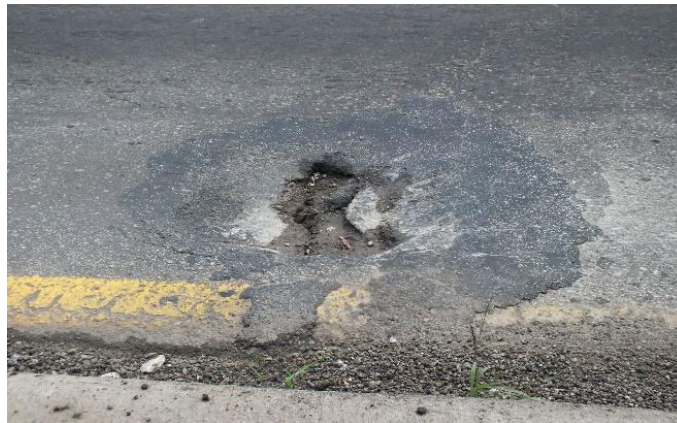
Figura 22 – Falha no pavimento Fonte: Autores
