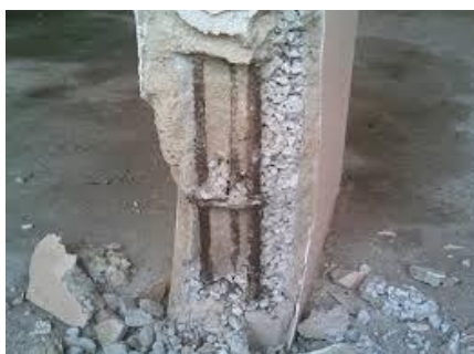
Figura 6- Desagregação do Concreto.
