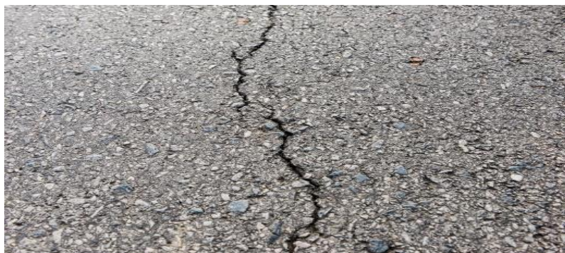
Figura 10- Trinca em asfalto velho. Fonte: Portal Deposit Photos.
