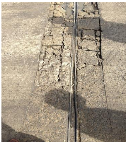
Figura 14- Patologia junta de dilatação dentada. Fonte: Portal ArchiEXpo.
