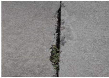
Figura 7- Vegetação em Junta de Dilatação.
