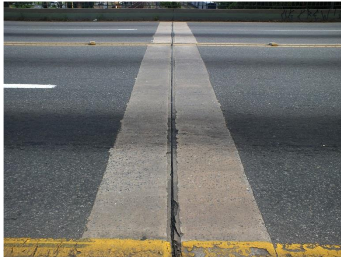
Figura 24 – Juntas de dilatação desgastadas Fonte: Autores
