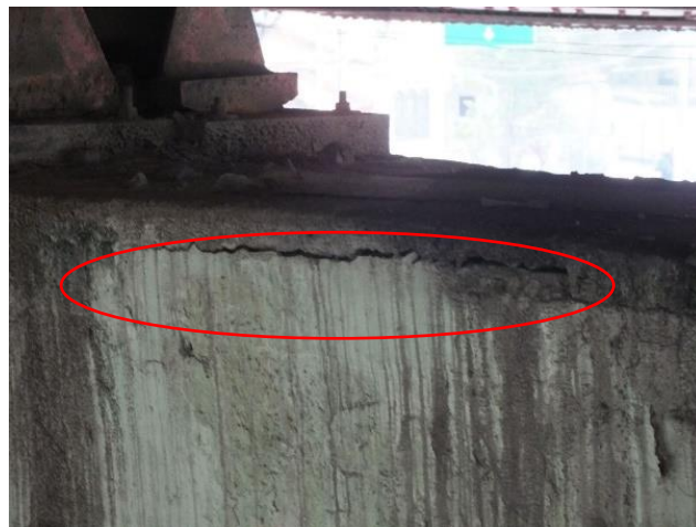
Figura 19 – Fissuras no tabuleiro
