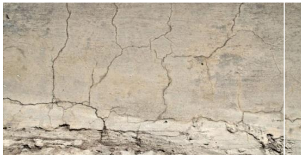
Figura 8- Retração do Concreto.
