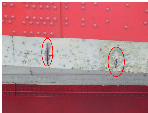
Figura 21 – Carbonatação no pilar Fonte: Autores
