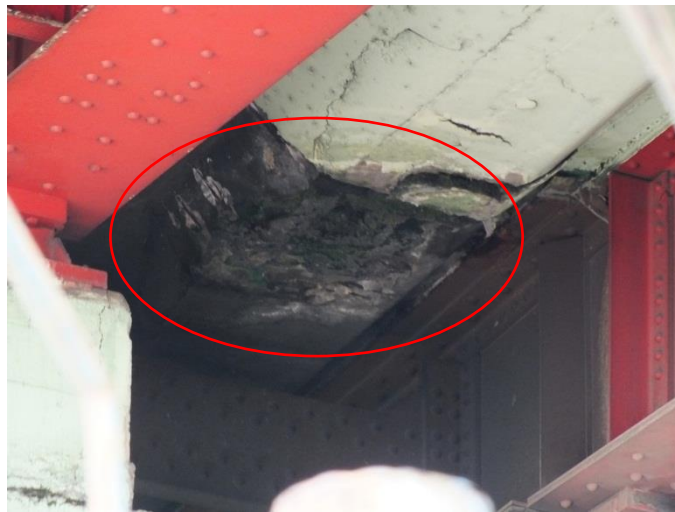
Figura 17- Lixiviação no tabuleiro Fonte: Autores
