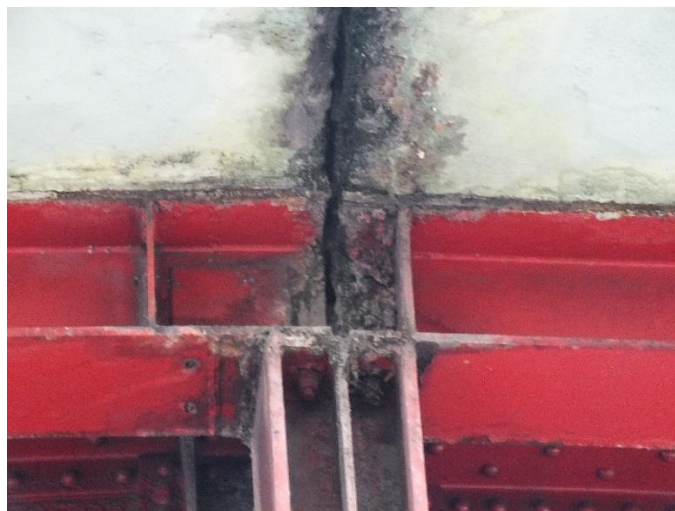
Figura 18 – Lixiviação no encontro de vigas Fonte: Autores
