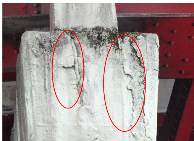
Figura 20 – Fissuras nos pilares de sustentação
