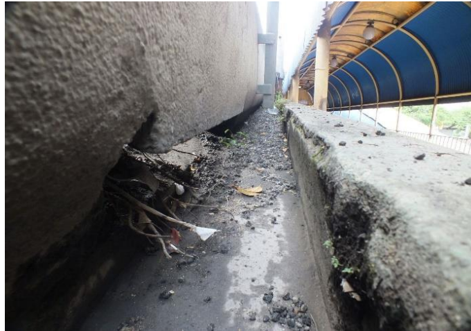
Figura 23 – Assoreamento de calhas Fonte: Autores
